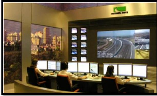
Figura 2.29. Centro de Control o Explotación de un túnel.
