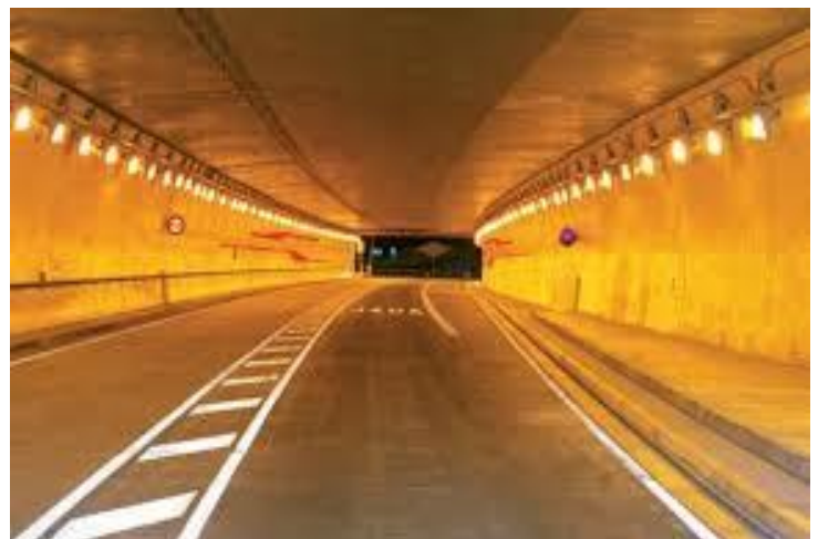
Figura 3.2. Luminaria tipo VSPA a la salida o acceso del túnel.
