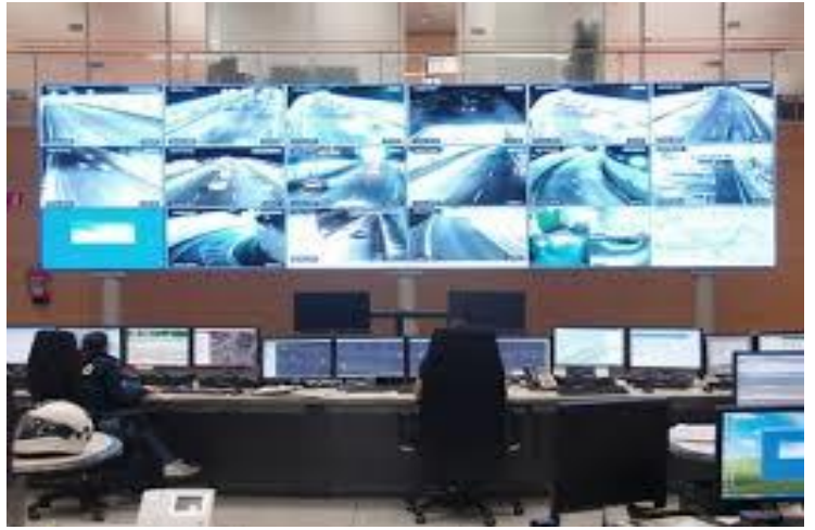
Figura 3.4. Centro de control.
