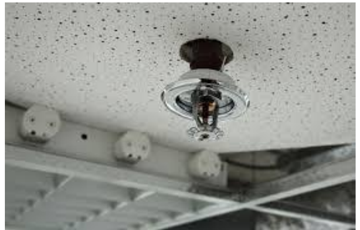
Figura 3.6. Sistema automático de extinción de incendio (Sprinkler).
