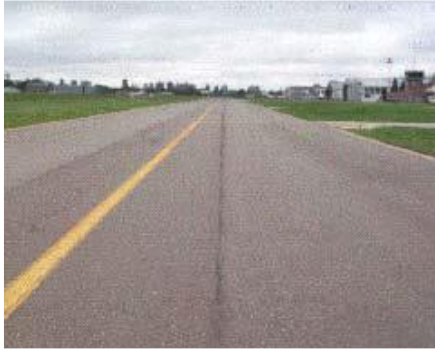
(Fig. 2.8 Fisuras longitudinales y transversales de baja severidad)
