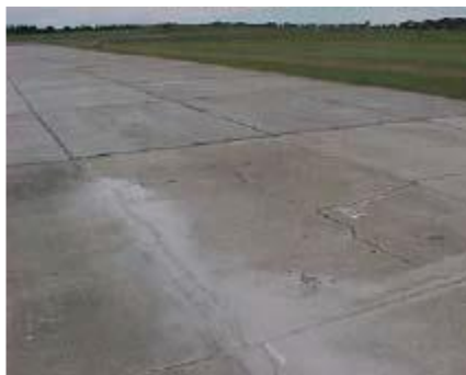
(Fig. 2.18 Losa cuarteada de baja severidad)
