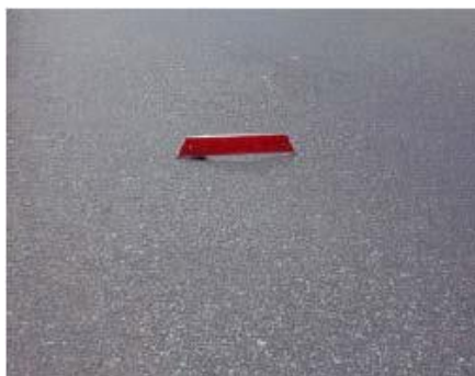
(Fig. 2.6 Depresión de baja severidad)
