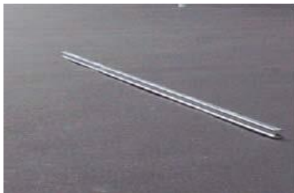
(Fig. 2.5 Ondulación de baja severidad)
