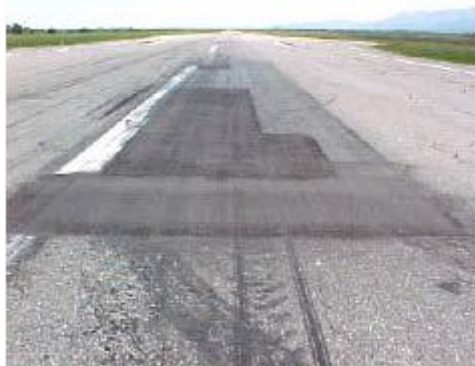
(Fig. 2.9 Bacheo de baja severidad).
