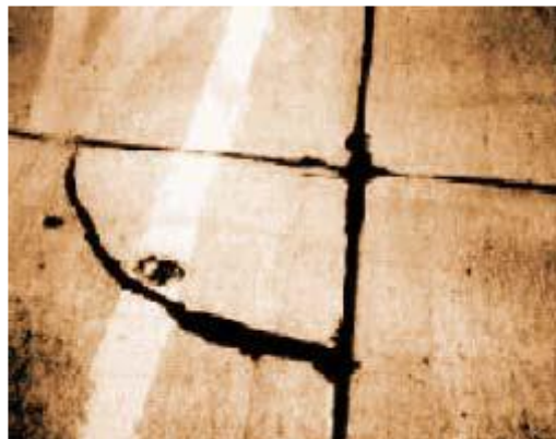
(Fig. 2.15 Rotura de esquina de severidad baja)
