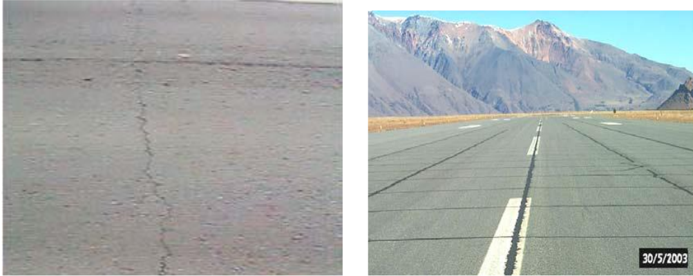
(Fig. 2.12 y 2.13 Reflexión de juntas de baja severidad)
