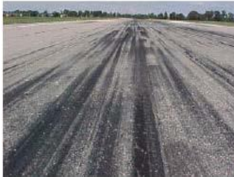
(Fig. 2.7 Erosión por Ráfaga de Jet)
