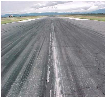
(Fig. 2.4 Fisura en bloque de baja severidad)
