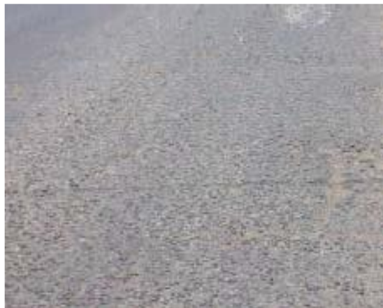
(Fig. 2.14 Peladura de baja severidad)
