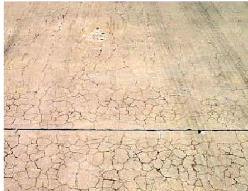
(Fig. 2.17 Mapa de fisuras de severidad baja).
