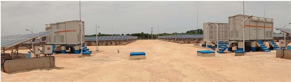
Figura 2.2 Parque Solar Fotovoltaico Cárdenas 3.
