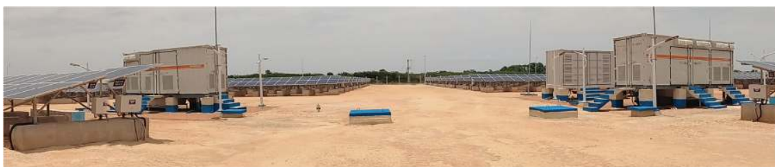
Figura 2.2 Parque Solar Fotovoltaico Cárdenas 3.
