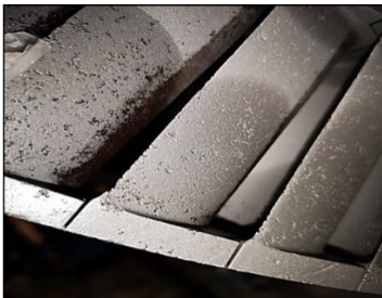
Figura 2.2. Álabes erosionados en la etapa de alta presión de la turbina de vapor. (Foto tomada por el autor, durante la actual investigación en el RAMP).
