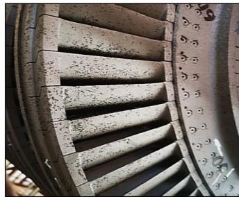
Figura 3.4 Álabes del rotor de Alta Presión con erosión por partículas sólidas. (Foto tomada por el autor durante la inspección del rotor de AMP en el año 2010, cuando fue sustituido).
