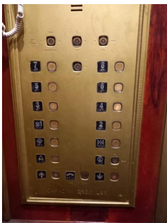
Señalización en Braille en el panel de los ascensores
