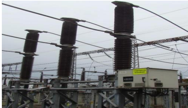
Figura 2.3: Interruptor de potencia tipo exterior.
