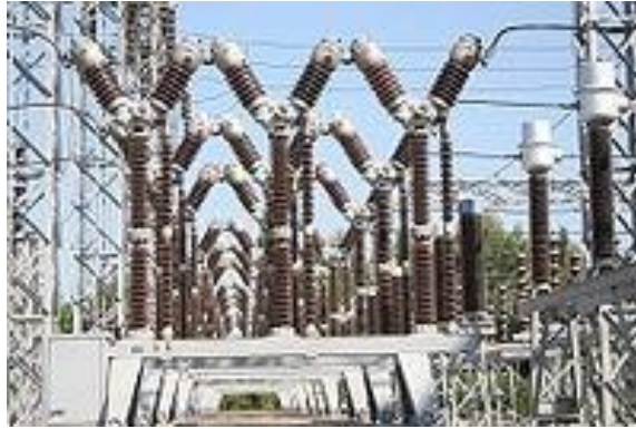
Figura 2.2: Subestación eléctrica elevadora.
