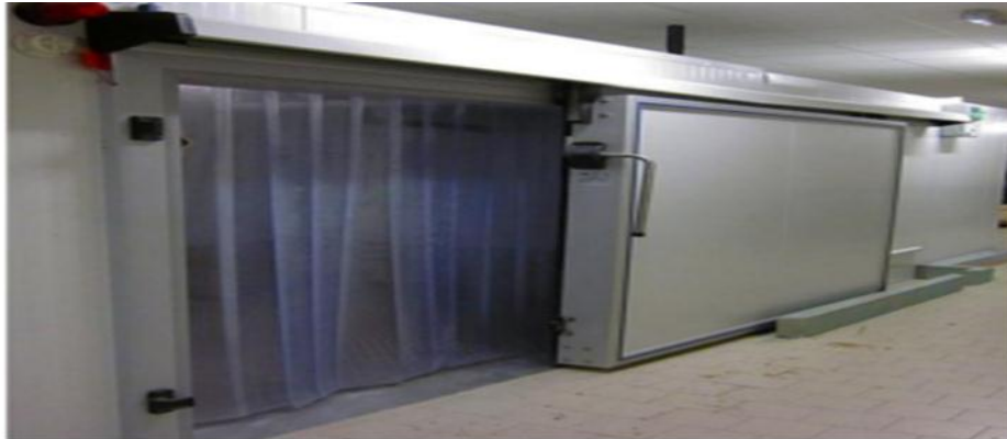
Figura F1: Puertas de correderas y cortinas lamas PVC cámara congelación y antecámara.
