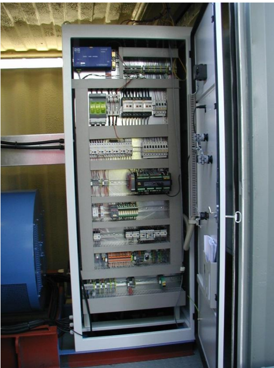
Panel de control de un grupo electrógeno.
