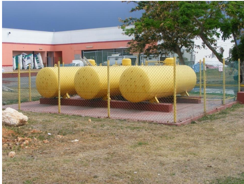
Figura 2.1 Vista Frontal de las Balas de Gas
