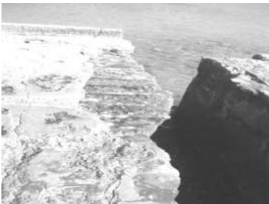
Foto 13. Losa de hormigón partida entre dos cajones.
