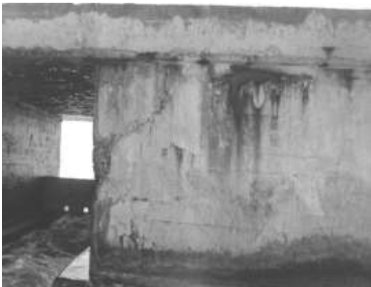
Foto 10. Defectos en Cajones.
