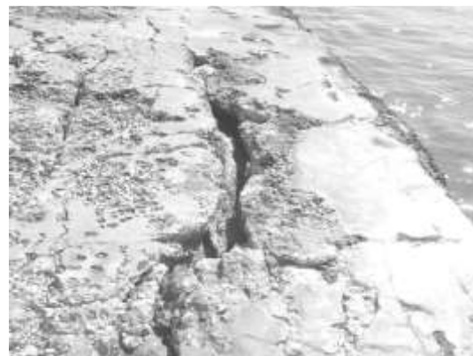
Foto 14. Grieta en la losa de hormigón.
