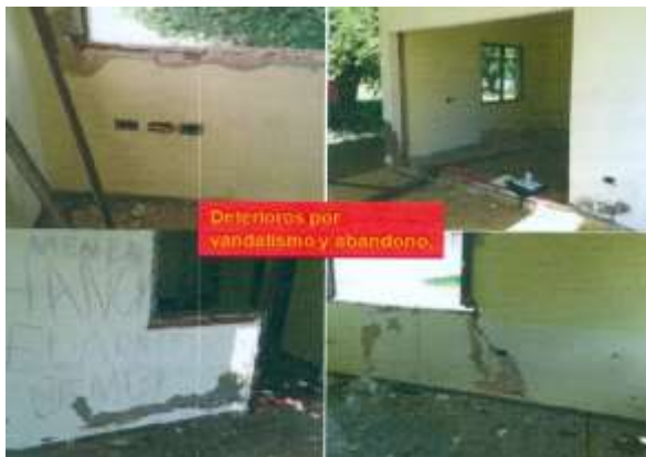
Figura 18. Deterioros por vandalismo y abandono.
