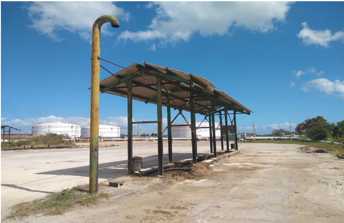
Anexo 10. Descargadero de pailas (Área 3).
