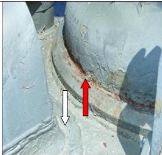
Fig.10 Imperfecciones en la superficie de soldaduras (blanco), zona de acumulación y depósito (rojo). Corrosión electroquímica atmosférica húmeda localizada y por celda de aeración diferencial.
