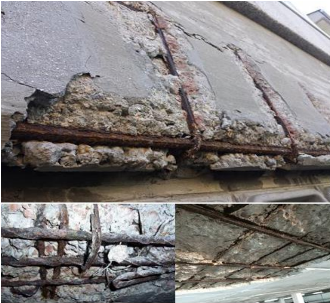
Figura 3: Ejemplos de las afectaciones que provoca la corrosión del acero en el hormigón armado. Oficina del Historiador de La Habana, Cuba.
