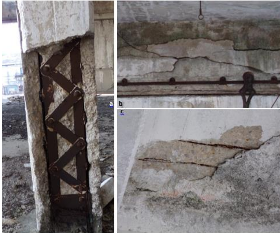
Figura 3.26 Abofado y desprendimiento. a: en columna, b: en viga y c: en losa. (Fuente: elaboración del autor)
