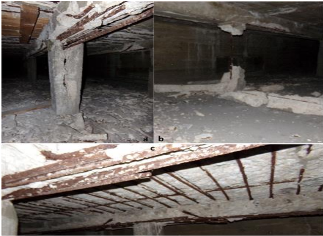
Figura 3.22 Deterioros del ático. a: viga destruida, b: Columna colapsada y c: losa con aceros corroídos. (Fuente: elaboración del autor)
