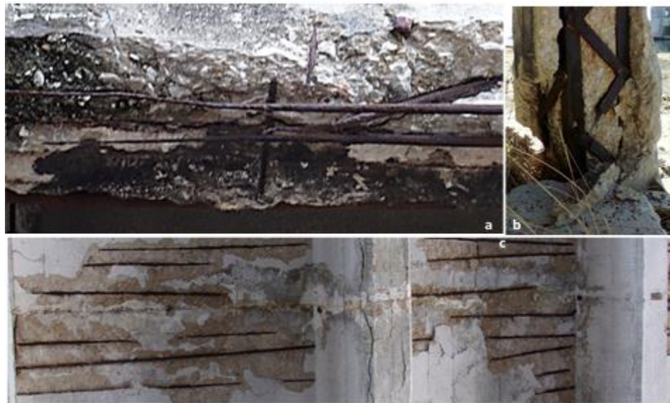
Figura 3.24 Aceros con pérdidas de sección. a: en viga, b: en columna y c: en losa.
