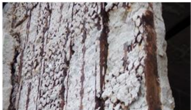
Figura 3.26a Corrosión de la malla nervada del muro
