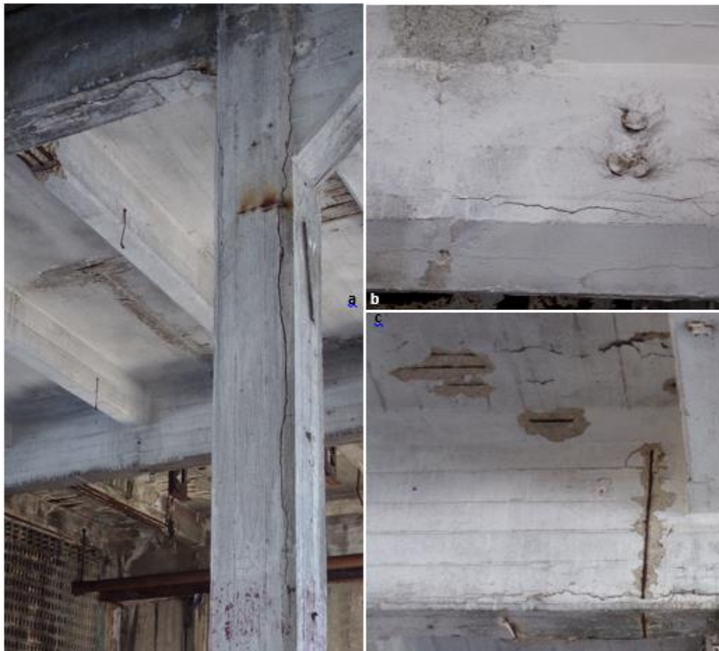
Figura 3.25 Grietas y fisuras. a: en columna y viga, b: en viga y c: en losa y viga.
