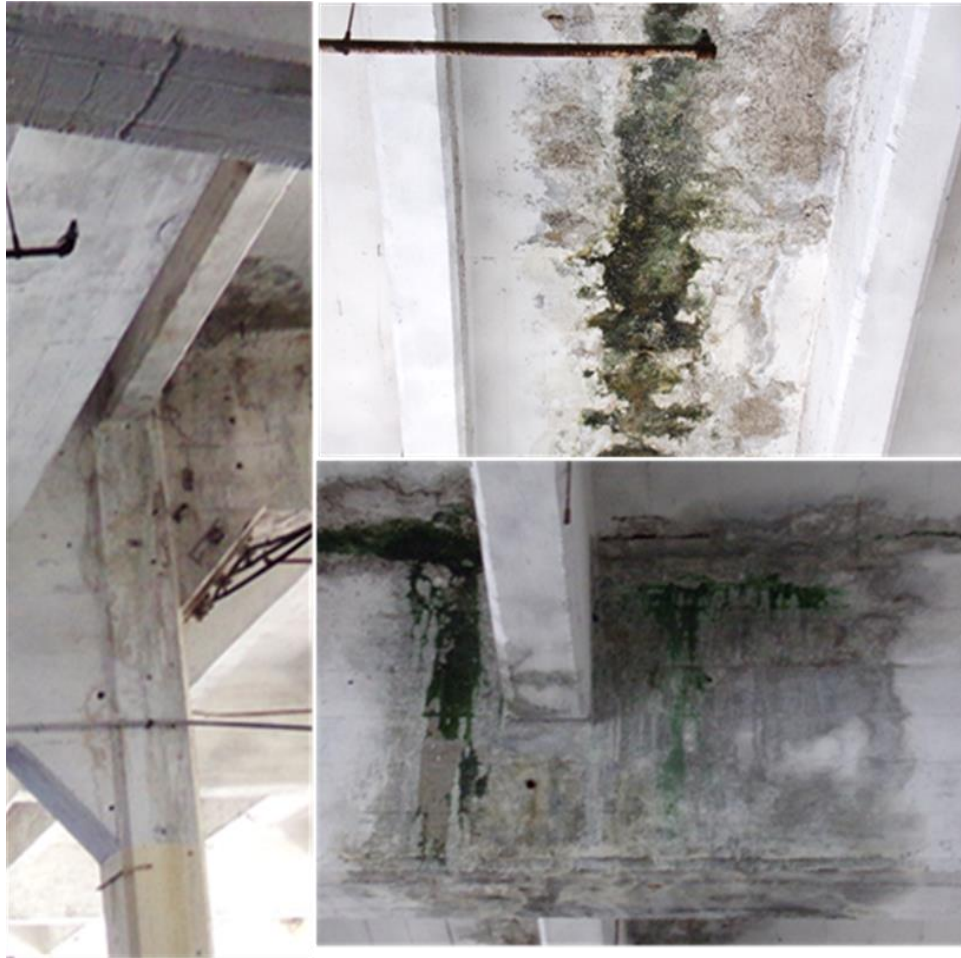
Figura 3.23 Lesiones asociadas a las humedades en los elementos. a: columna, b: viga y c: viga y losa. (Fuente: elaboración del autor)
