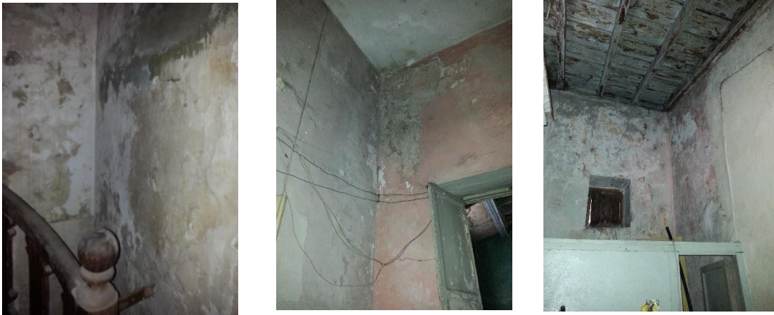
Figura 2.8: Humedades del primer nivel. Fuente: Elaboración propia.
