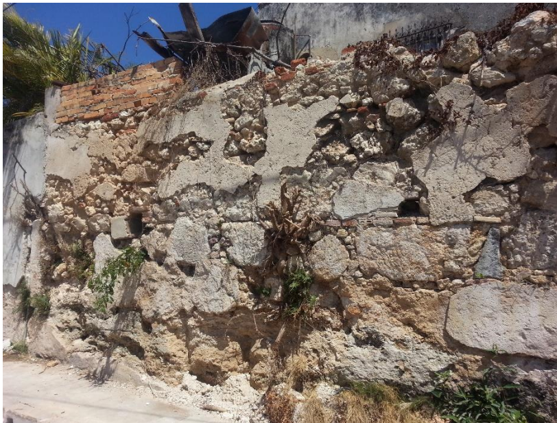
Figura 2.7: Condiciones muro exterior. Fuente: Elaboración propia.
