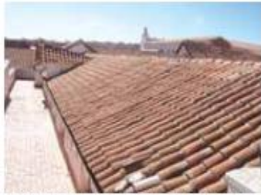
La cubierta a restaurar, con problemas de filtraciones
