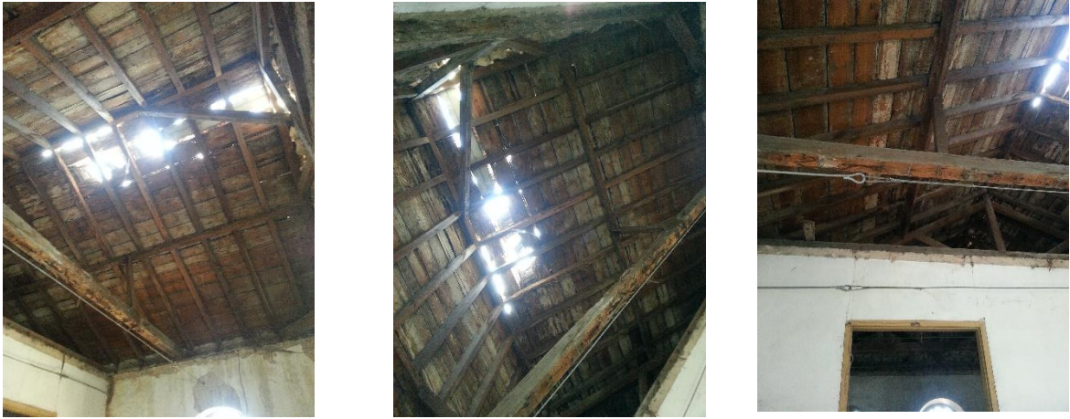
Figura 2.4: Estado cubierta del segundo nivel. Fuente: Elaboración propia
