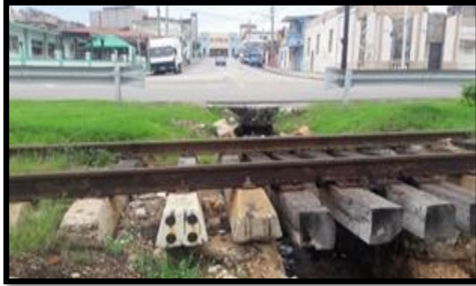
Figura 2.2.2: Línea del ferrocarril ubicada en la intersección con el trazado de la propuesta de diseño.
