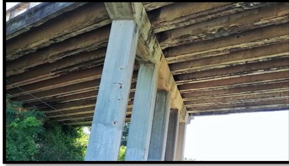
Figura 2.5: Pérdida de sección en los elementos estructurales. (Elaboración propia)
