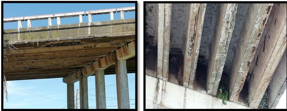
Figura 2.6: Presencia de vegetación en la estructura. (Elaboración propia)
