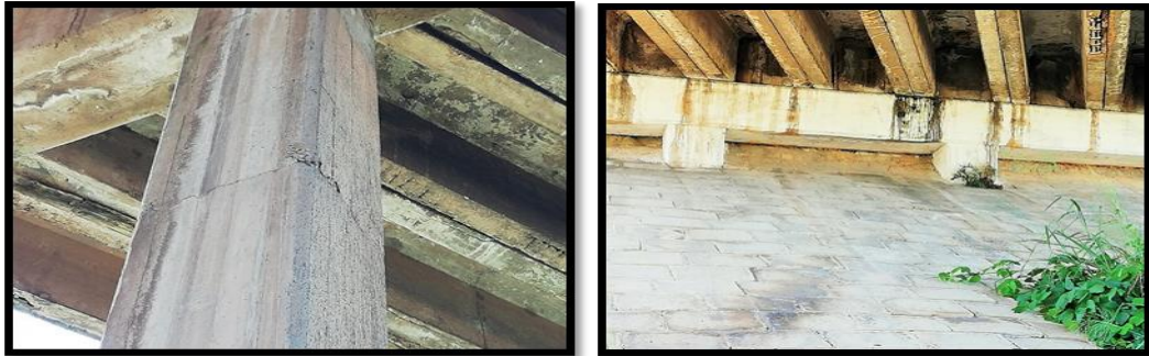
Figura 2.8: Agrietamiento y presencia de humedad. (Elaboración propia)
