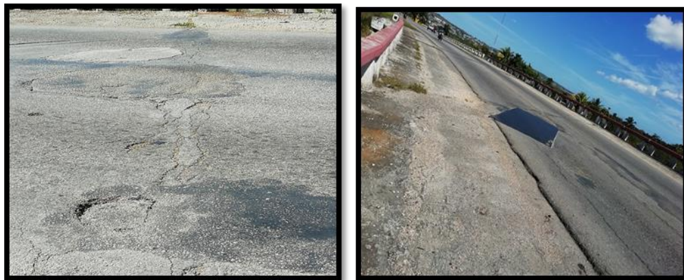
Figura 2.7: Bacheo y pérdida de la capa de rodadura. (Elaboración propia)
