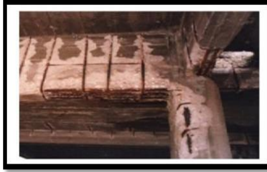
Figura 1.7: Efectos en el hormigón armado. (Prieto, 2013).
