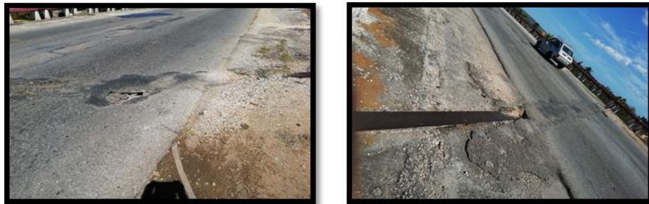
Figura 2.4: Juntas de dilatación en mal estado. (Elaboración propia)
