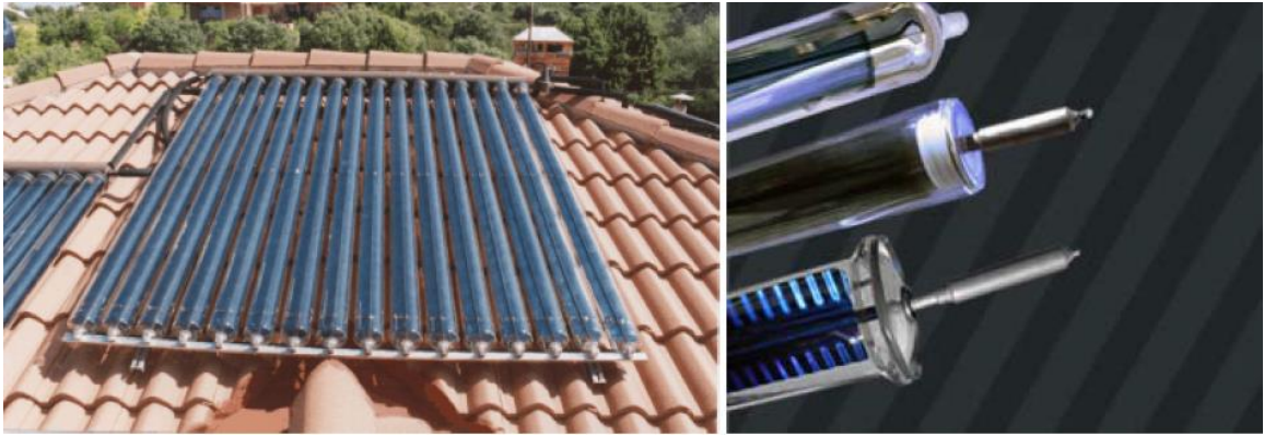
Figura 1.8 Foto de colectores Heat-Pipe y varios tipos de tubos al vacío
