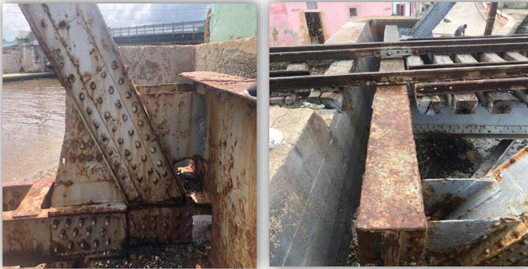
Figura 2.2 Estado de los estribos de hormigón. Fuente: Elaboración propia.
