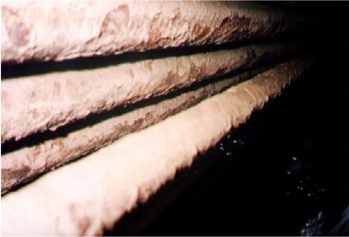
Figura 1.1. Incrustaciones en los tubos de las calderas pirotubulares.
