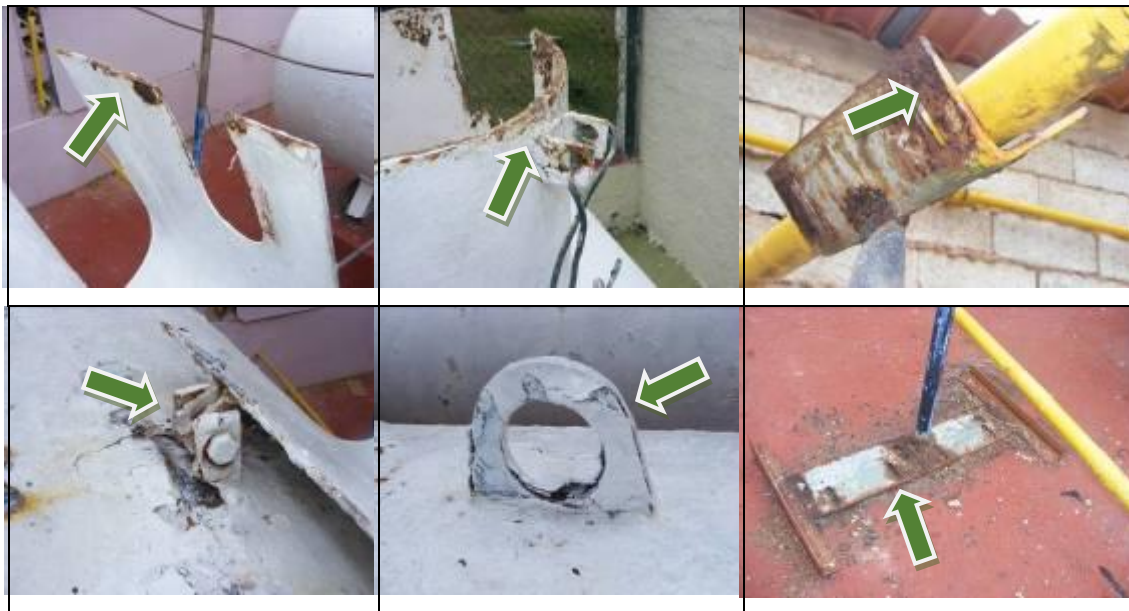
Imperfecciones de la superficie de la soldadura.
