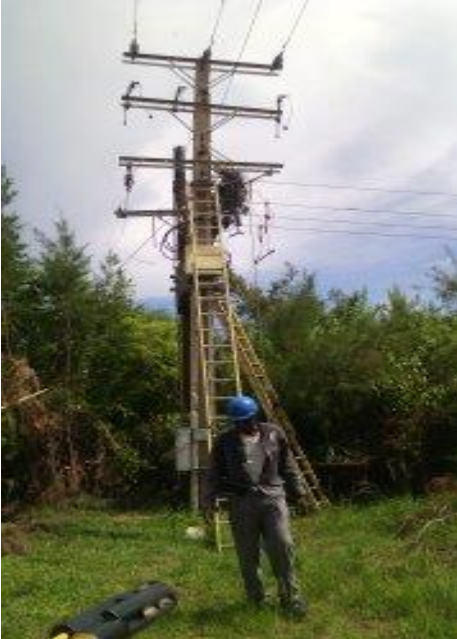
Foto No 1: Eliminación de la cobertura boscosa para la construcción de una línea eléctrica aérea, muy próximo al área protegida de la península.
