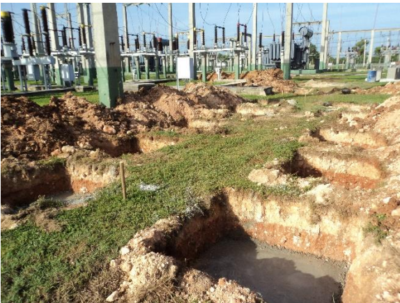
Foto No 3: Ampliación de una subestación en la Península Hicacos. Al fondo se encuentra la autopista. El proyecto no incluye medidas de enmascaramiento para limitar el impacto visual que produce en el entorno.
