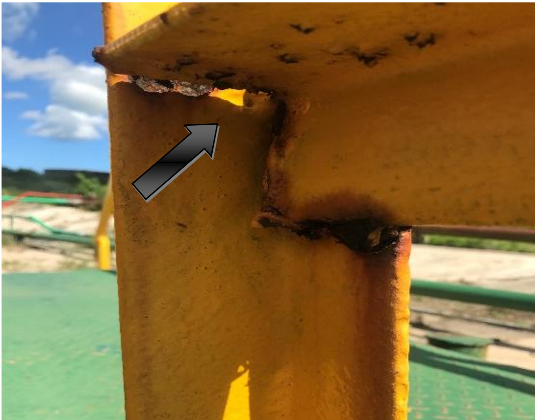
Figura 2.3. Se observan uniones de soldaduras por puntos
