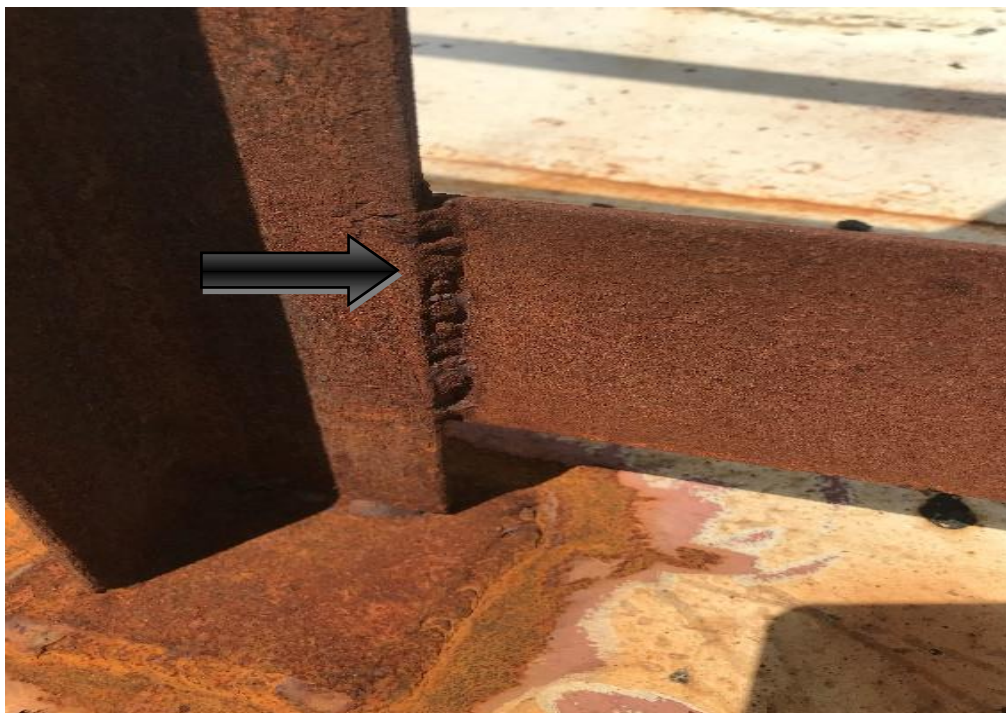
Figura 2.3.1 Imperfecciones en las superficies de soldadura
