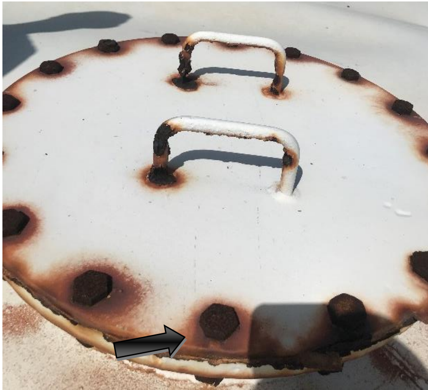
Figura 2.5. Uniones con pernos con falta de recubrimiento
