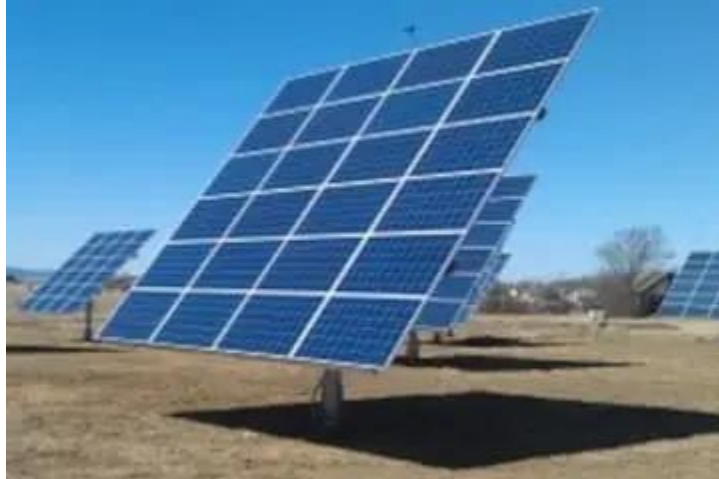
Figura 1.16 Instalación de Seguidor Solar. (Fuente: https://mipanelssolar.com/img/blog/seguidor-solar-360x240.webp )
