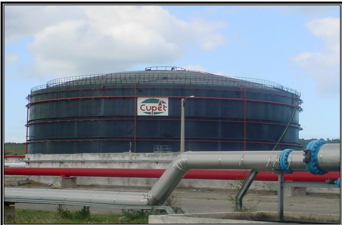
Anexo # 3. Tanque receptor de crudo # 28
