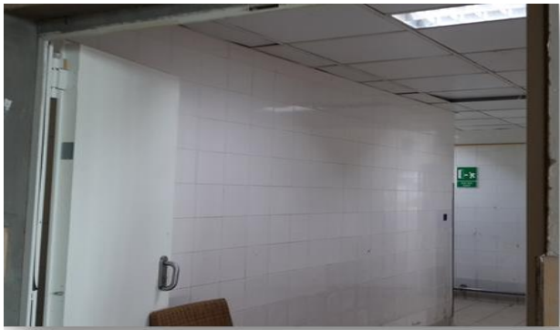
Figura 3.3. Puerta en mal estado del área de fregado
