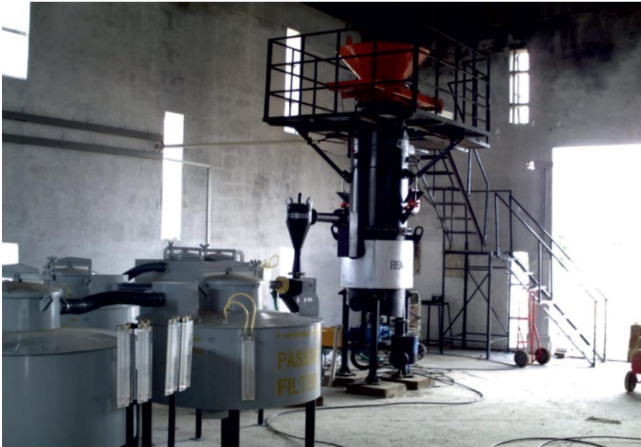
Figura A.1. Gasificador instalado en la EEPF Indio Hatuey.
