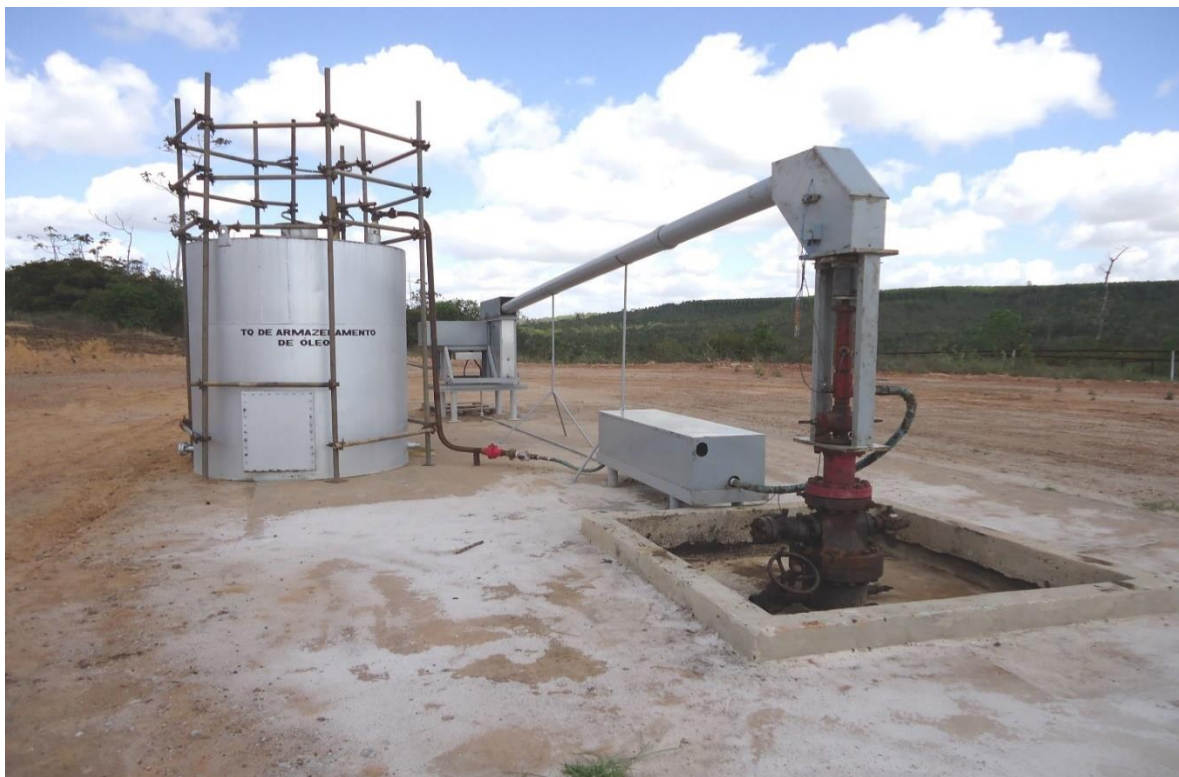
Figura 2.4: Sistema Recoil instalado en el pozo P-X
