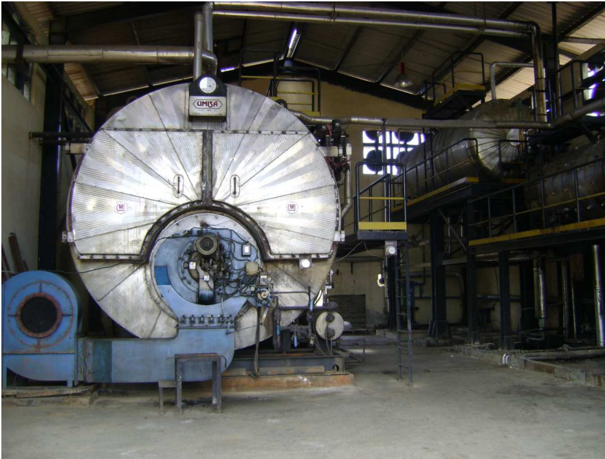
Fig. No 2 a-) Caldera pirotubular de la Empresa Comercializadora de Combustibles Matanzas.
