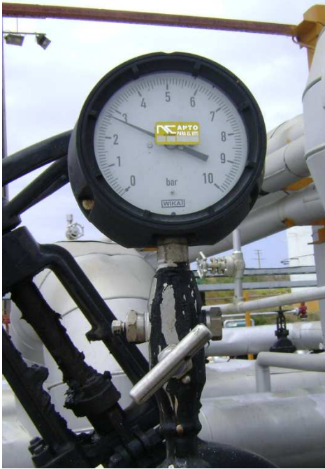
Fig. No 2 d-) Manómetro medidor de Presión (bar), a la entrada del Intercambiador de CTE Este Habana.
