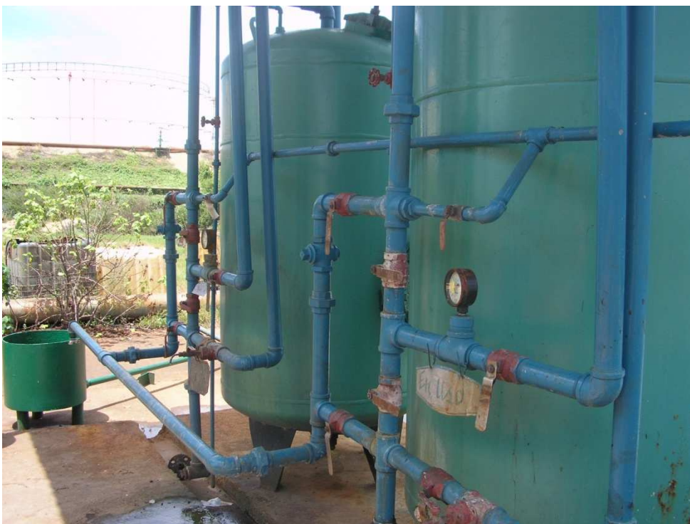
Fig. No 2 c-) Suavizadores donde se le hace el tratamiento previo al agua de calderas, para eliminar su dureza total.
