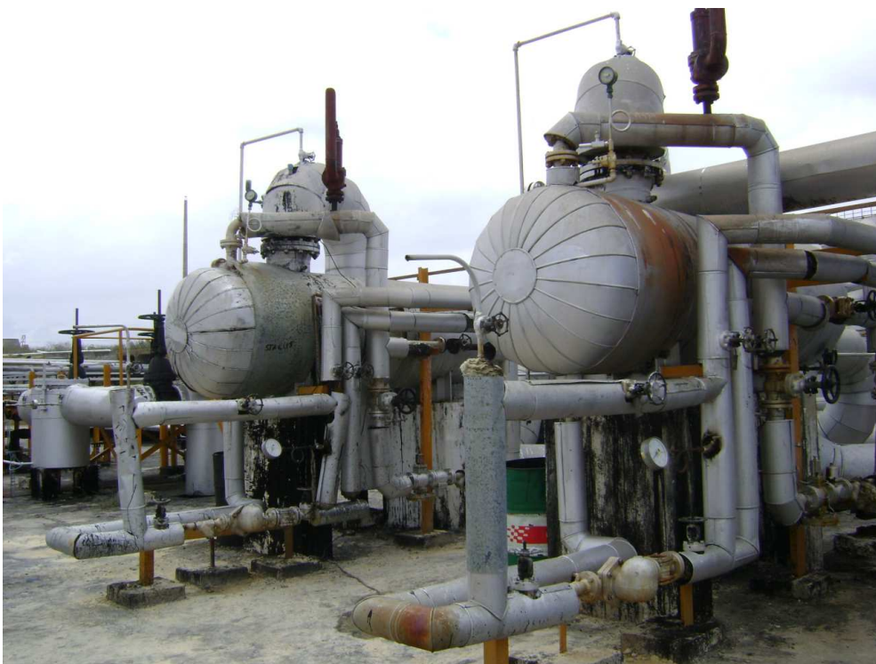
Fig. No 2 c-) Intercambiadores de Calor: CTE A. Guiteras y CTE. Este Habana.
