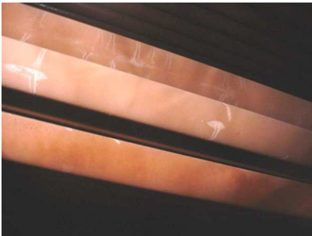
Fig. No 1 b-) Imagen de los tubos que se encuentran en el interior de la caldera, afectada por el pH ácido, antes de la limpieza química.
