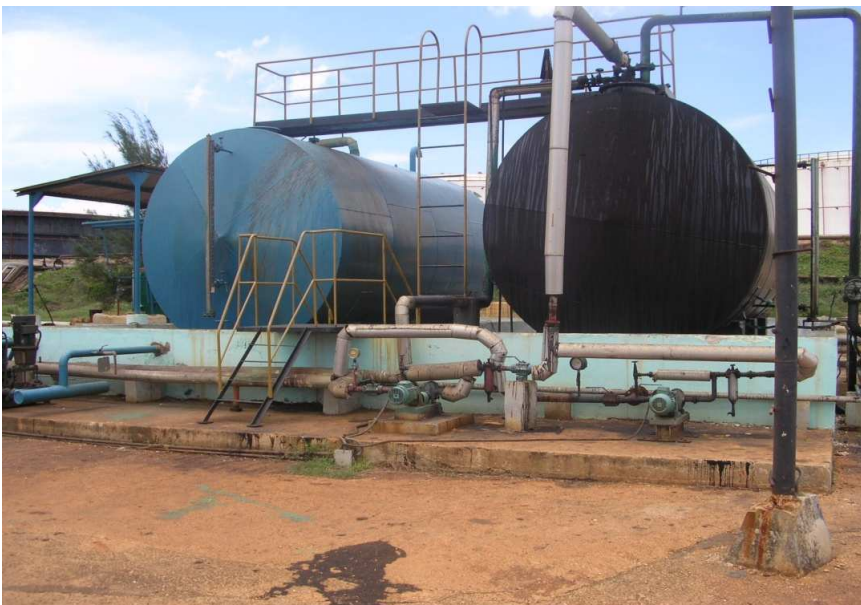
Fig. No 2 b-) Tanques de almacenamiento de Agua y Combustible, de la Caldera, de la Empresa Comercializadora de Combustibles Matanzas.
