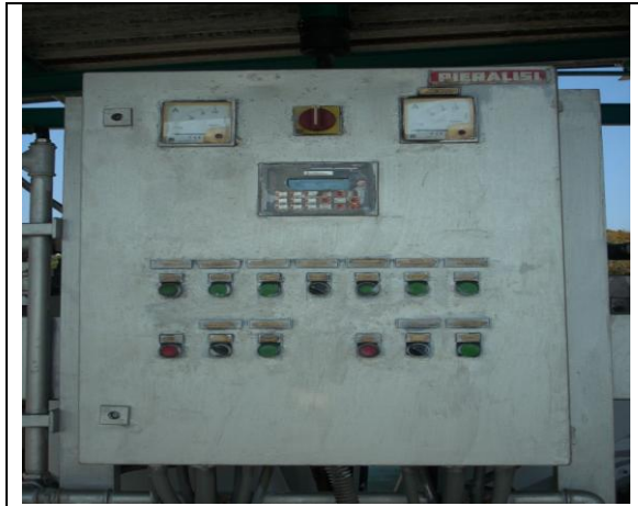
Figura 2.30 Vista general de la pizarra de control.
