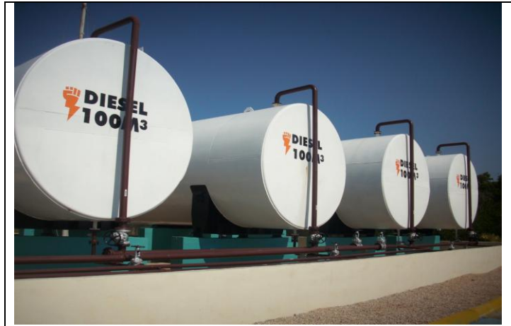
2.2 Vista de los tanques de Combustible.
