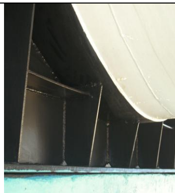
Figura 2.4 Problema de retención de humedad, depósitos y agua.
