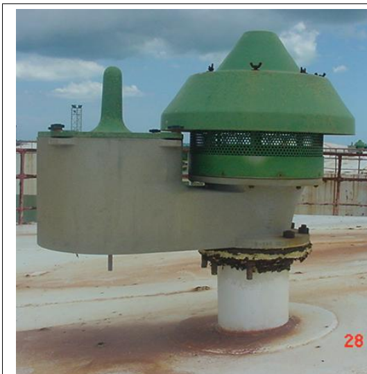
Figura 2.3 Válvula de presión y vacío.
