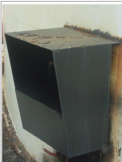
Figura 2.10 Caseta de los toma muestra.
