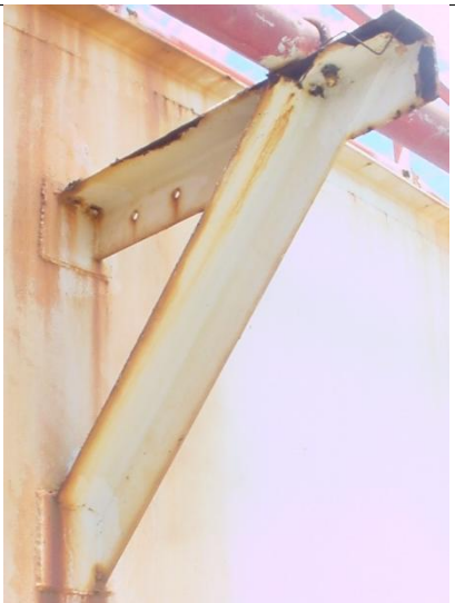
Figura 2.12 Apoyos del sistema contra incendios
