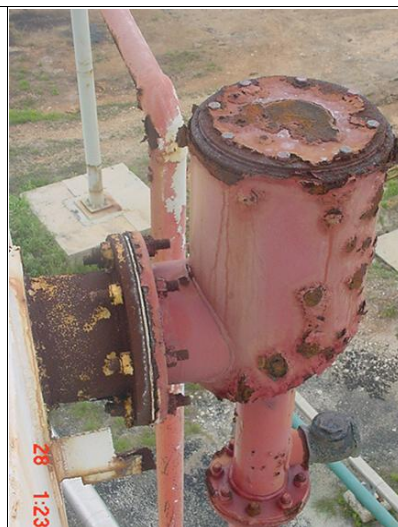
Figura 2.15 Sistema contra incendio.
