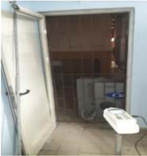
Figura 3.4. Puerta en mal estado que comunica la sala de máquinas con la lavandería
