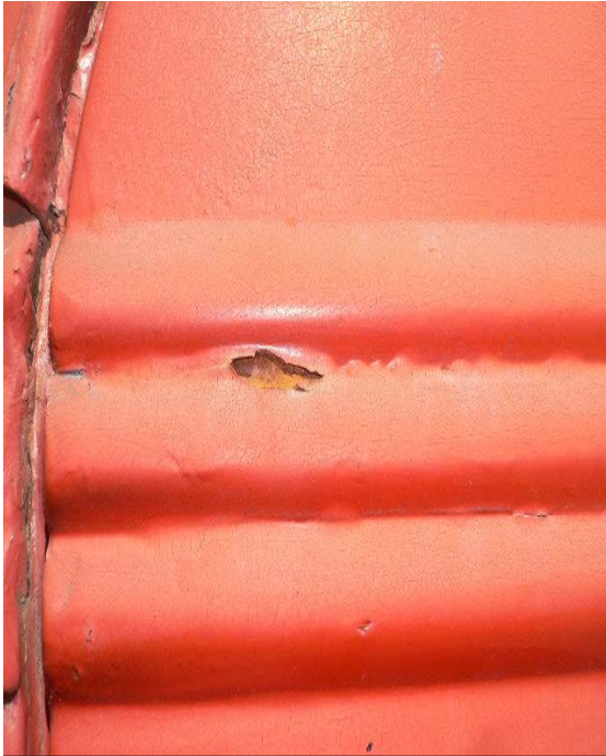
Fig. 13 Mala preparación superficial, corrosión interfacial.
