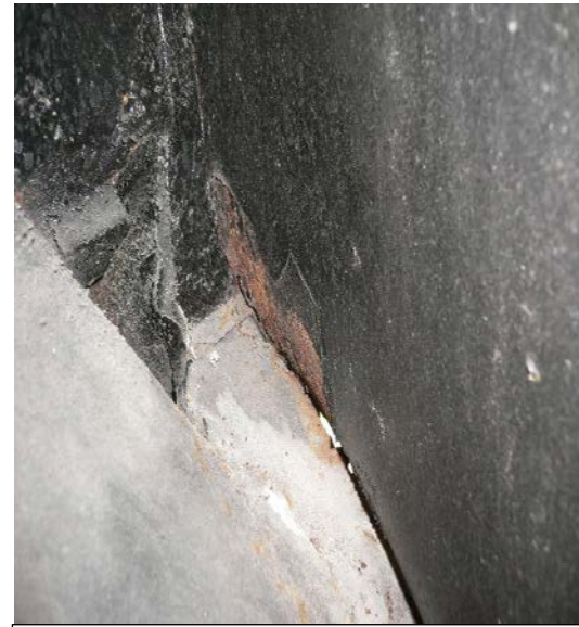
Fig. 44 Soldadura irregular, bordes, resquicios y preparación superficial inadecuada. Corrosión por celda de aireación diferencial, intersticial y atmosférica localizada.
