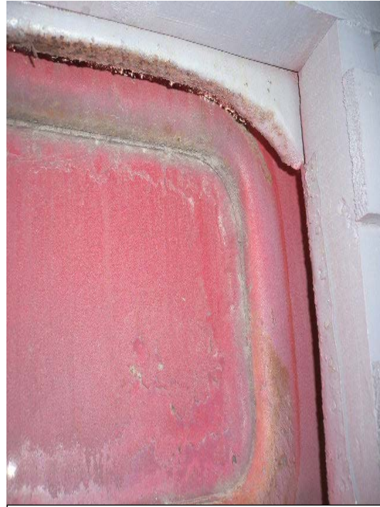
Fig. 38 Resquicios y zona inaccesible. Corrosión localizada por celdas de concentración y en resquicios.
