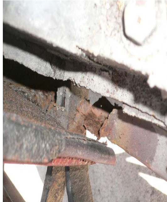
Fig. 46 Bordas, resquicios y ausencia de recubrimiento protector. Corrosión por picadura y localizada por celda de aireación diferencial.
