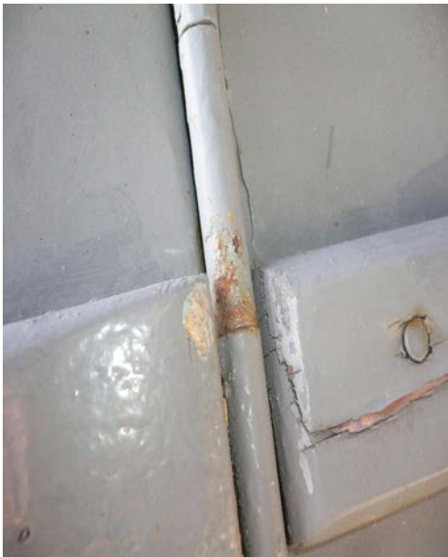
Fig. 27 Resquicios en uniones metal-metal y metal-madera. Corrosión por celda de aireación diferencial.
