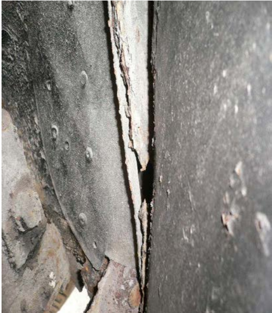
Fig. 47 Solape, intersticio, conexiones con pernos y bordas. Corrosión por resquicios, interfacial, atmosférica localizada y por celdas de aireación superficial.
