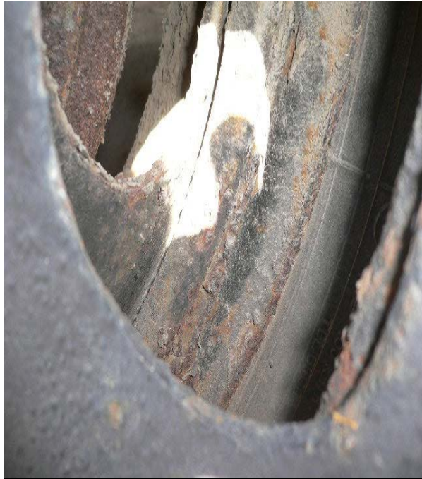
Fig. 30 Resquicios en la unión metal-goma. Corrosión intersticial y celdas de aireación diferencial.
