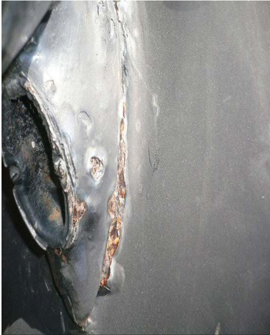
Fig. 9 Soldadura irregular, presenta corrosión localizada por celdas de aireación diferencial.
