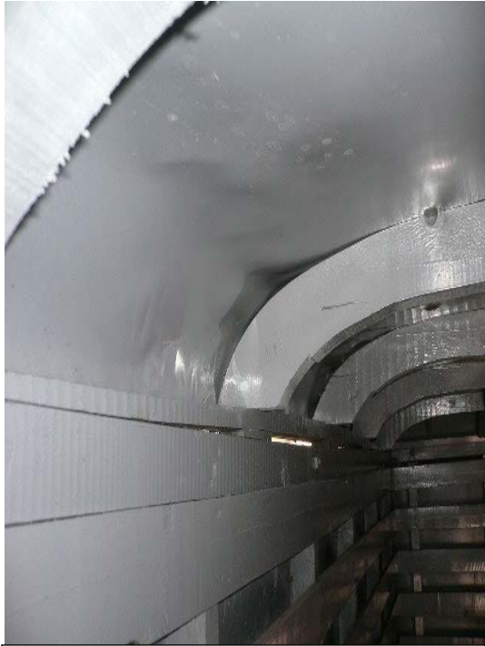
Fig. 37 Resquicios y accesibilidad. Corrosión localizada.
