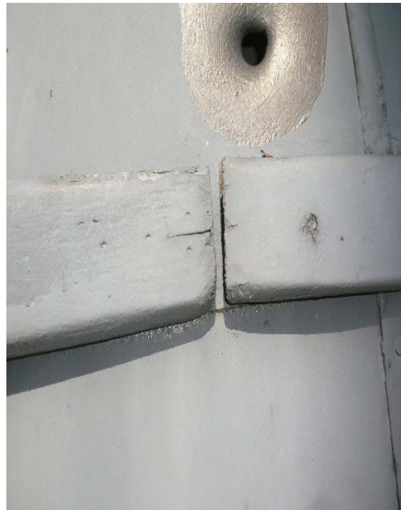
Fig. 22 Área cerrada, refuerzos, resquicios y orificios. Corrosión atmosférica intersticial y en el área cerrada puede aparecer corrosión por celdas de aireación diferencial.
