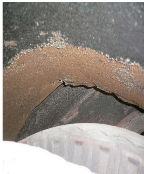
Fig. 28 Preparación superficial inadecuada. Corrosión localizada y por celdas de aireación diferencial.
