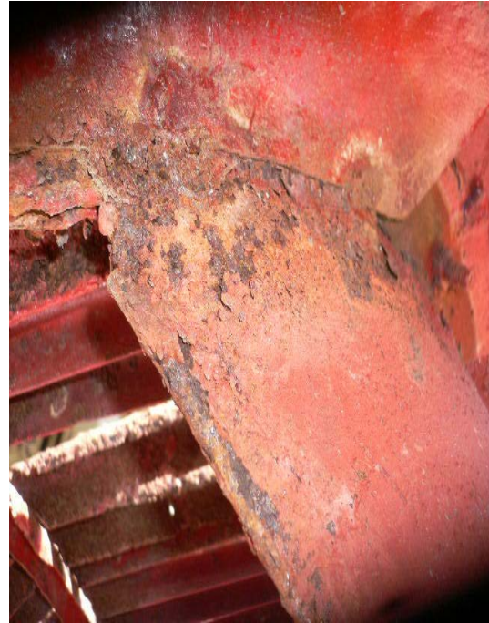
Fig. 42 Mala preparación superficial y resquicio. Corrosión por picadura, intersticial, atmosférica localizada e interfacial.
