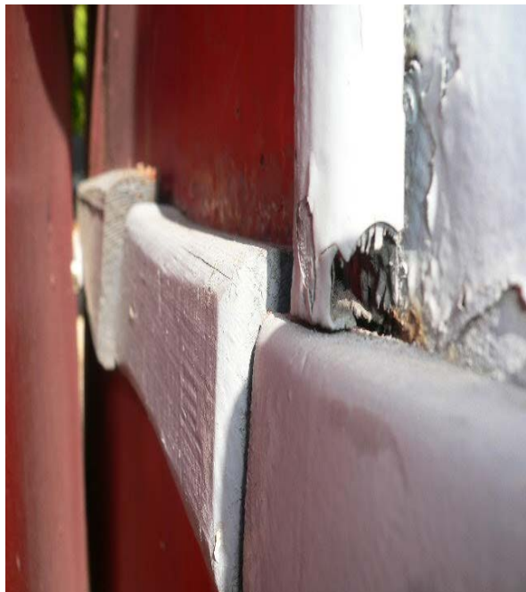
Fig. 32 Intersticios, mala preparación superficial y acumulación y depósitos. Corrosión intersticial e interfacial.
