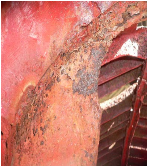
Fig. 43 Soldadura discontinua y mala preparación superficial. Corrosión picadura, resquicio y atmosférica localizada.
