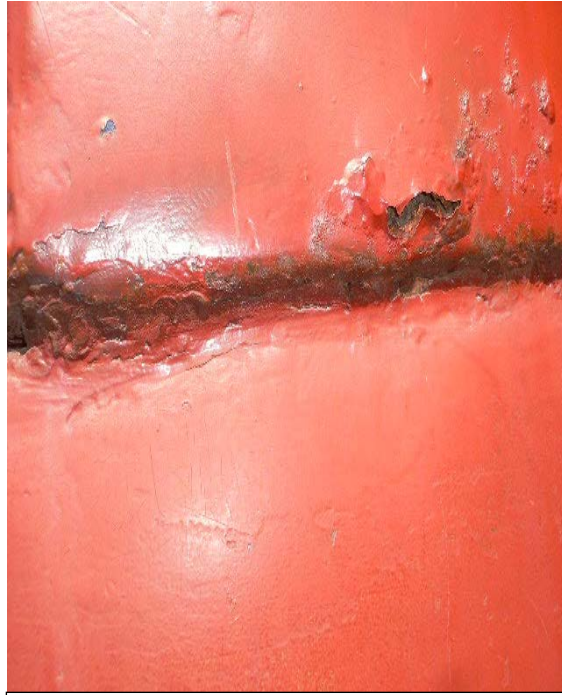
Fig. 18 Soldadura irregular. Presenta corrosión galvánica por celdas de aireación diferencial.
