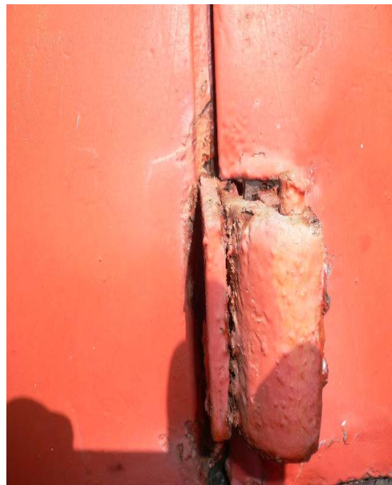
Fig. 12 Soldadura irregular, intersticios y celdas de aireación diferencial.
