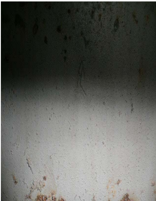
Fig. 39 Mala preparación superficial. Corrosión por celdas de aireación diferencial.
