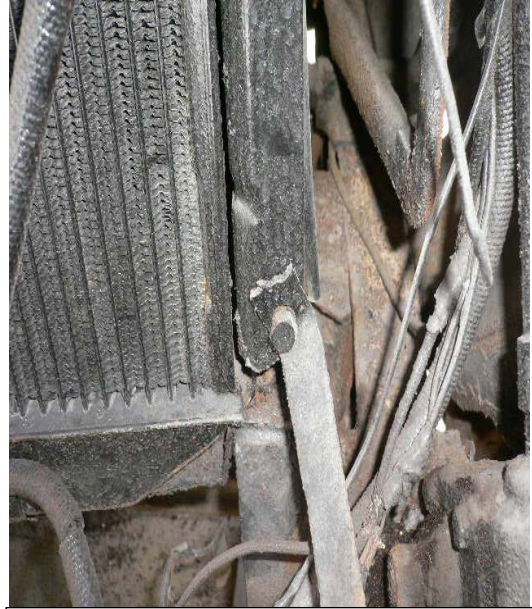
Fig. 48 Zona de acumulación y depósito, accesibilidad, conexiones con pernos. Corrosión localizada por celda de aireación diferencial.
