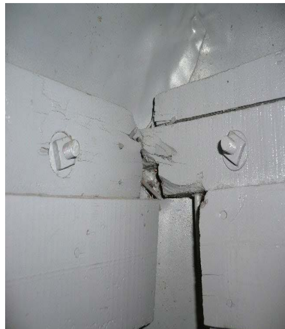
Fig. 36 Accesibilidad, pernos y resquicios. Puede presentar corrosión localizada.
