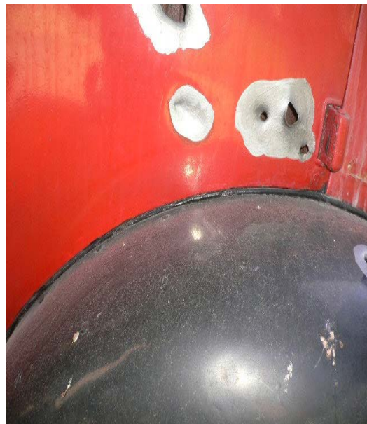
Fig. 2 Área cerrada y resquicio, puede presentar corrosión atmosférica mojada y/o húmeda e intersticial.
