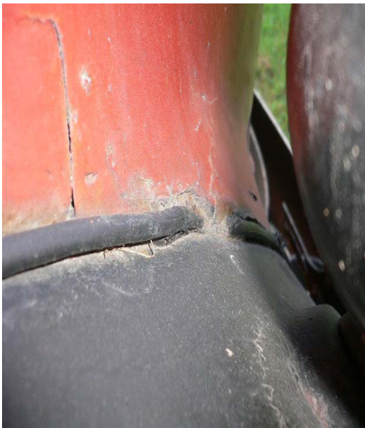
Fig. 3 Soldadura discontinua y resquicio, puede presentar corrosión por resquicio.
