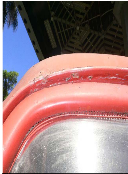
Fig. 14 Zonas de acumulación y depósitos, mala preparación superficial, resquicios. Presenta corrosión atmosférica húmeda y/o mojada, interfacial, por celdas de aireación diferencial.
