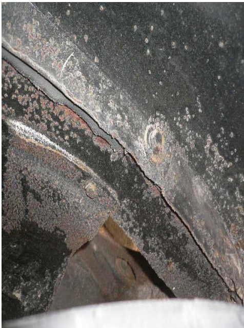
Fig. 19 Conexión con perno, resquicios y falta de preparación superficial. Se presenta corrosión en resquicios y localizada por celdas de aireación diferencial.
