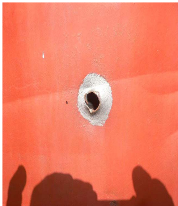
Fig. 24 Área Cerrada. Corrosión atmosférica húmeda por celdas de aireación diferencial.
