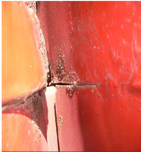
Fig. 20 Resquicios en uniones metal-metal. Corrosión galvánica por celdas de aireación diferencial.
