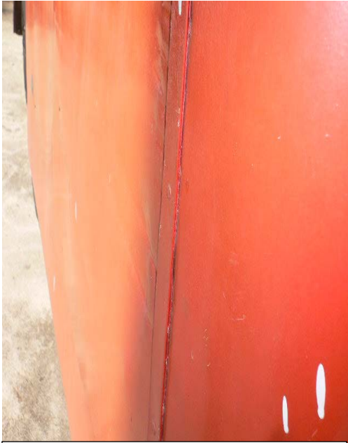
Fig. 25 Refuerzo metálico que crea resquicios. Corrosión en resquicios.
