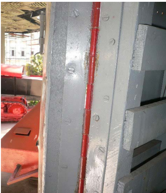
Fig. 35 Problemas de accesibilidad. Presenta corrosión por celdas de aireación diferencial.
