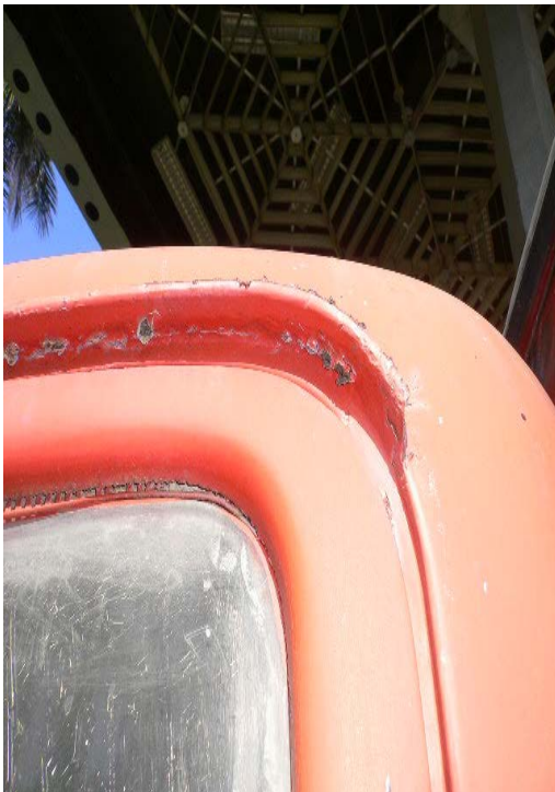
Fig. 15 Zonas de acumulación y depósitos, mala preparación superficial, resquicios. Presenta corrosión atmosférica húmeda y/o mojada, interfacial, por celdas de aireación diferencial.
