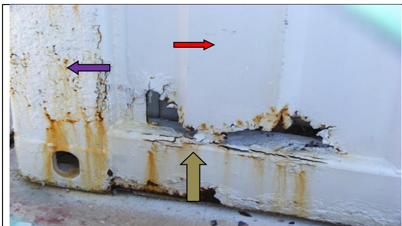
Fig 5. Mala preparación superficial (violeta). Resquicios (rojo). Componente hueco (gris). Corrosión por picadura y celdas de aireación diferencial.
