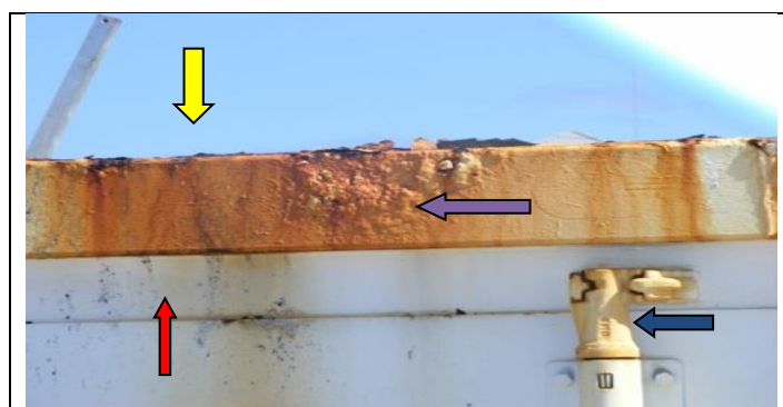
Fig 1. Zona de acumulación de depósitos (amarilla), resquicios (rojo), mala preparación superficial (violeta), accesibilidad (azul). Presenta corrosión atmosférica húmeda y/o mojada por celdas de aireación diferencial.
