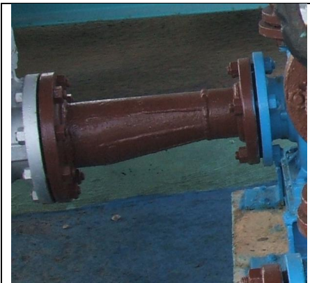
Figura 2.36 Tuberías del área de sistema de bombeo.
