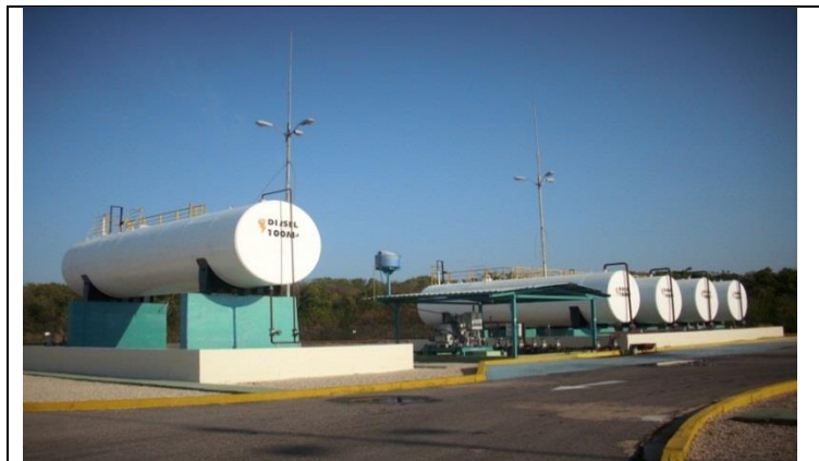
Figura 2.1 Vista general del área de combustible.
