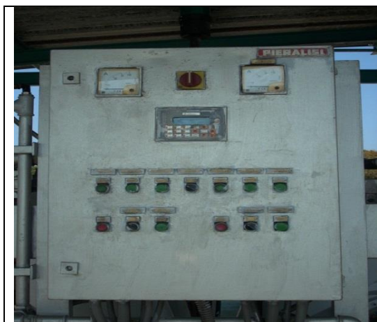
Figura 2.21 Vista general de la pizarra de control.
