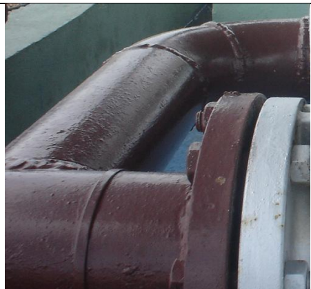
Figura 2.37 Tuberías del área de sistema de bombeo.
