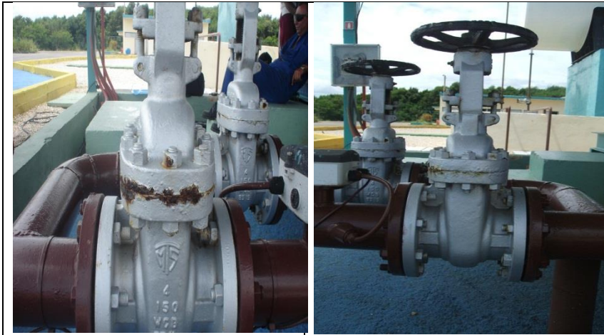
Figura 2.28 Orificio en unión entre bridas y orificio-perno Figura 2.29 Unión entre bridas en la parte superior de la bombas
