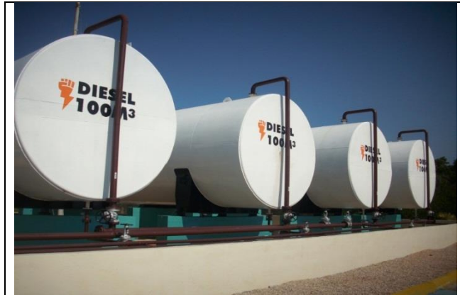
2.2 Vista de los tanques de Combustible.
