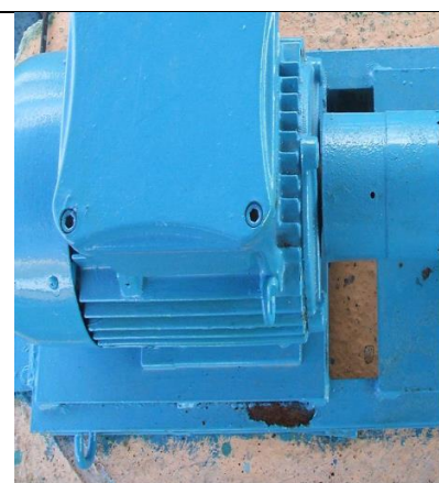
Figura 2.40 Parte superior del motor de la bomba.
