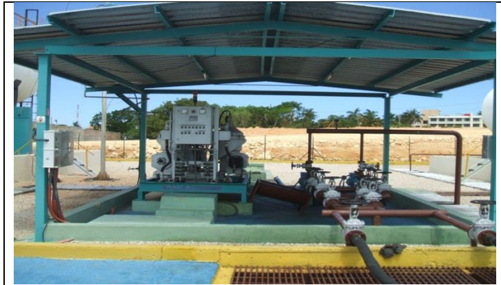
Figura 2.12 Vista general del área de centrífuga.
