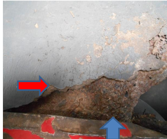
Fig.26 Área cerrada, acumulación de depósito y humedad (azul), resquicios, ausencia de recubrimiento (roja).
