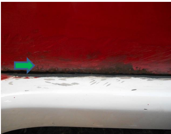
Fig. 19 Resquicios y zona de acumulación de depósito, humedad y mala preparación superficial (verde). Presenta corrosión electroquímica atmosférica húmeda, en resquicios, por celdas de aireación diferencial e interfacial.
