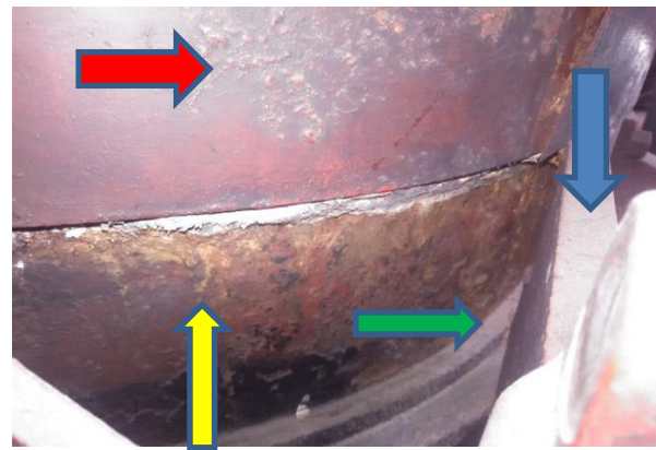
Fig.7 Resquicios (verde), acumulación de depósitos (azul), mala preparación superficial (roja) y ausencia de recubrimiento (amarilla).
