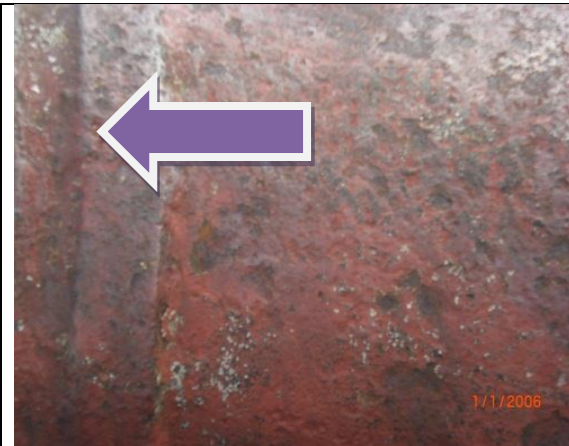
Fig. 19. Presenta imperfecciones en las superficies de las soldaduras y mala preparación superficial. Corrosión por celdas de aireación diferencial.
