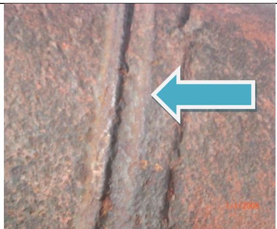
Fig 14. Presenta problemas de imperfecciones en las superficies de las soldaduras y ausencia de
