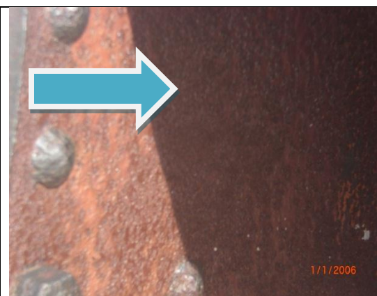
Fig 5. Presenta problemas de accesibilidad, resquicios y ausencia de recubrimiento. Corrosión por celdas de aireación diferencial, en resquicios.
