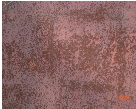
Fig. 18. Presenta mala preparación superficial. Presenta corrosión por celdas de aireación diferencial.
