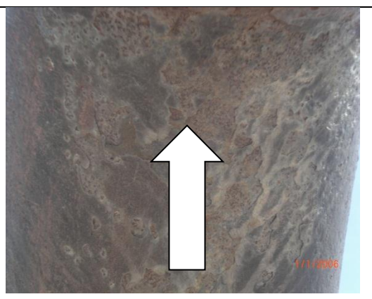
Fig 6. Presenta problemas de accesibilidad y mala preparación superficial. Corrosión picadura electroquímica atmosférica húmeda.
