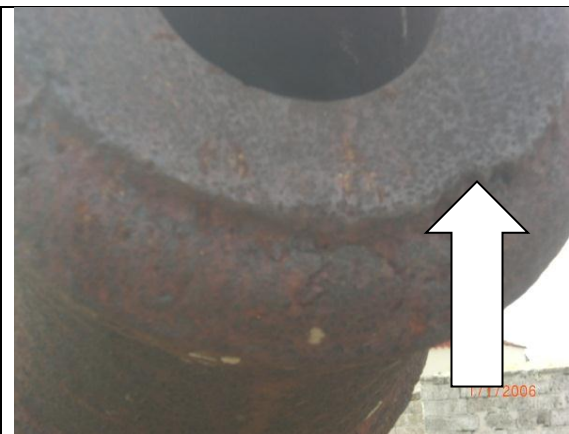
Fig. 21. Presenta bordes y mala preparación superficial. Corrosión por celdas de aireación diferencial.
