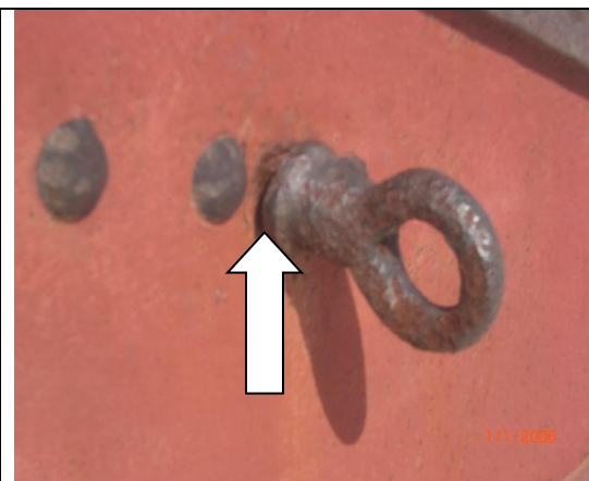
Fig 3. Presenta resquicios y mala preparación superficial. Corrosión en resquicios y por celdas de aireación diferencial.
