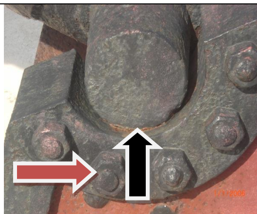
Fig 4. Presenta conexiones con pernos, resquicios y zonas de retención de humedad, depósitos y agua. Corrosión en resquicios, electroquímica atmosférica localizada y generalizada, húmeda y mojada, por celdas de aireación diferencial.
