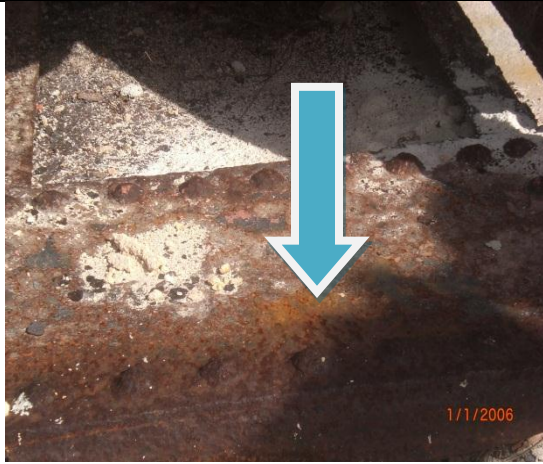
Fig 11. Presenta zonas de retención de humedad, depósitos y agua, resquicios. Corrosión electroquímica generalizada. Corrosión atmosférica
