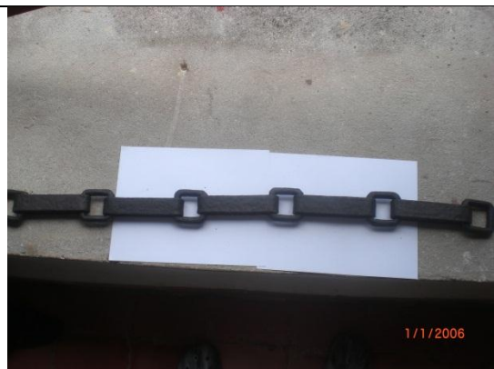
Fig. 34. Grillete. Presenta corrosión electroquímica atmosférica generalizada.
