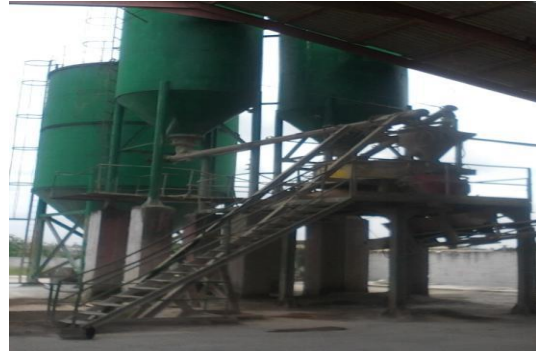
Figura A.9.2 Tolvas de recepción del agua y el cemento.
