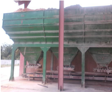
Figura A.9.1 Tolvas de recepción de los áridos finos y gruesos.
