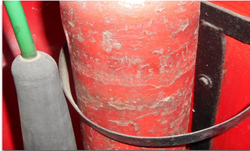
Fig. 3.4 Problemas de preparación superficial
